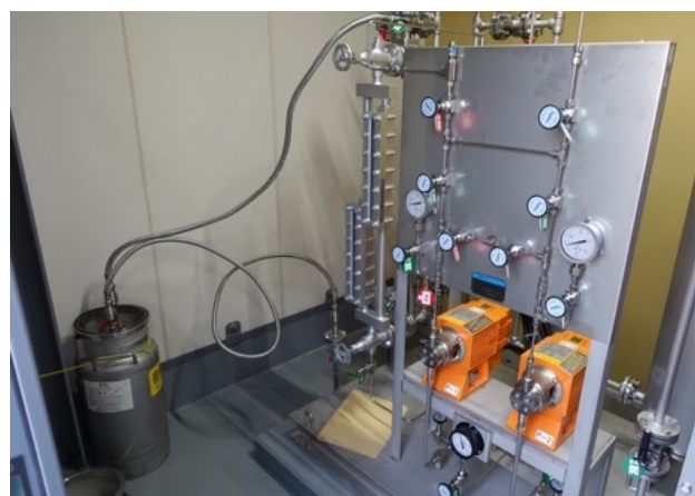
全自動付臭装置
