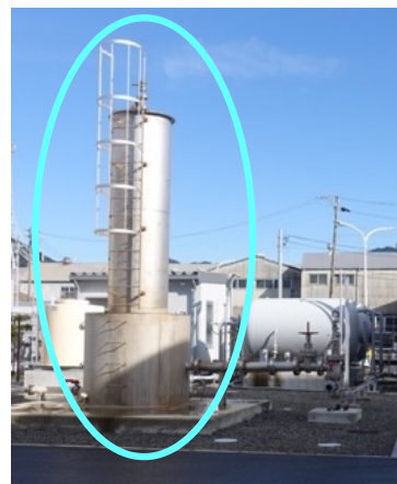
メタン分離槽
