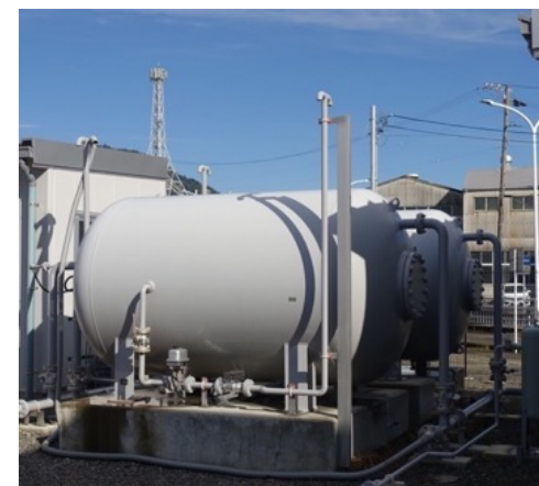
ガス貯蔵タンク
