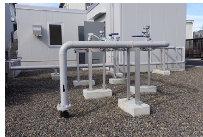
都市ガス供給管
