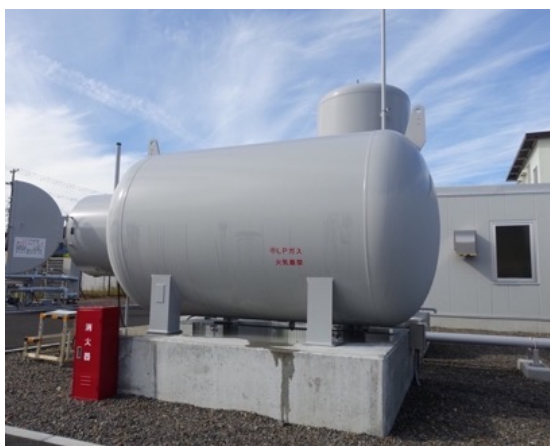
増熱用LPガス貯蔵タンク
