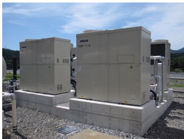
ガスエンジン発電機(25 kW x 4基)
