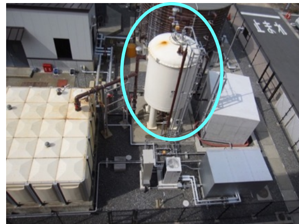
メタン分離槽
