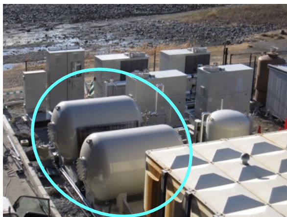
ガス貯蔵タンク
